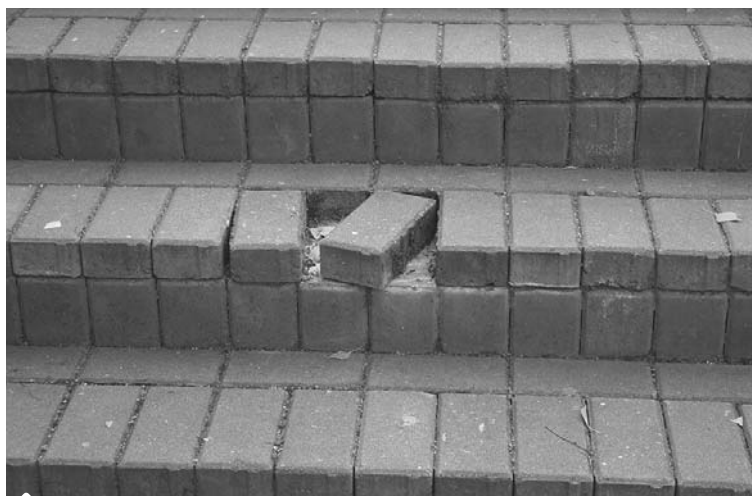
Schody u Sokolovny, u kterých se neustále uvolňuje zámková dlažba, na svoje "opraváře" teprve čekají.
